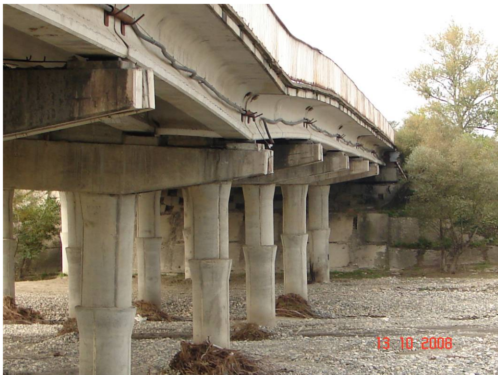
Фрагмент моста через р. Кубань. Вид на опору № 6 после катастрофического паводка в июле 2008 г.
