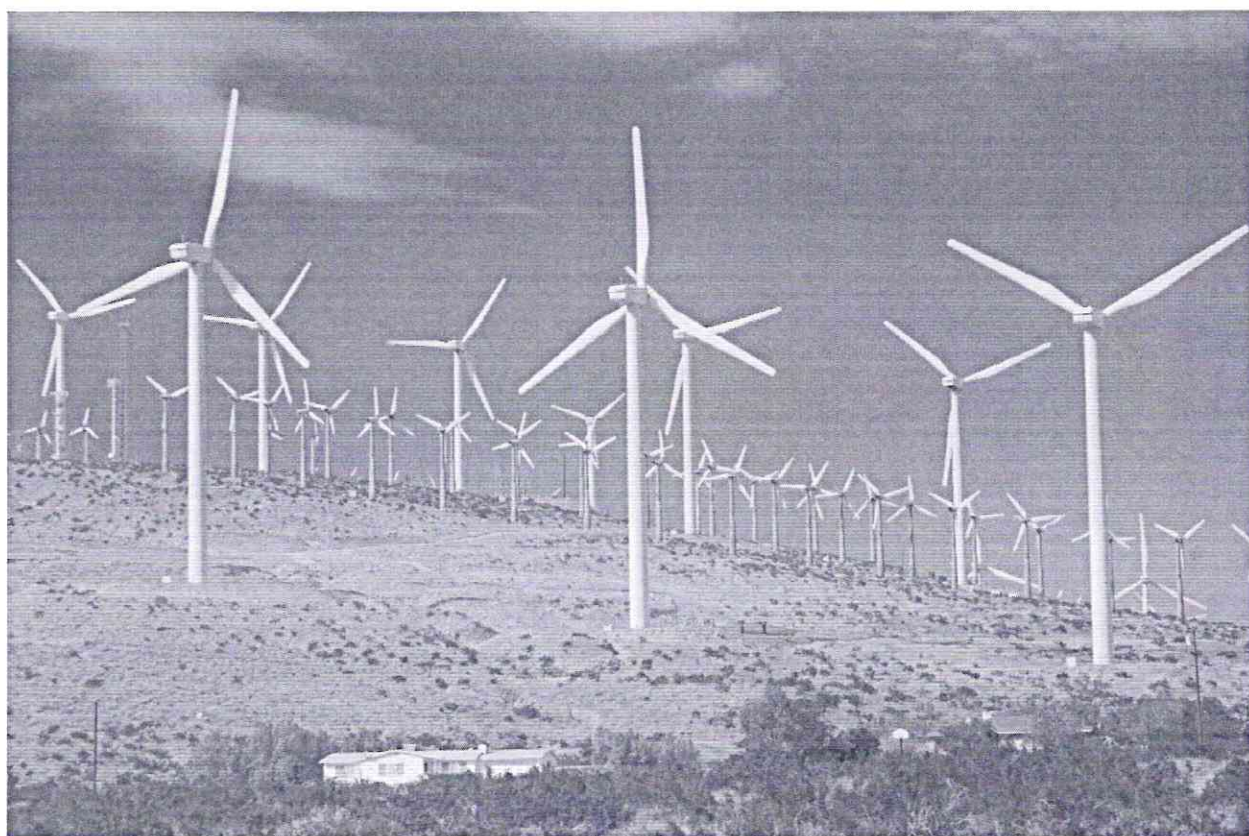
Рисунок 1.1 – Крупная ветроэнергетическая станция.
