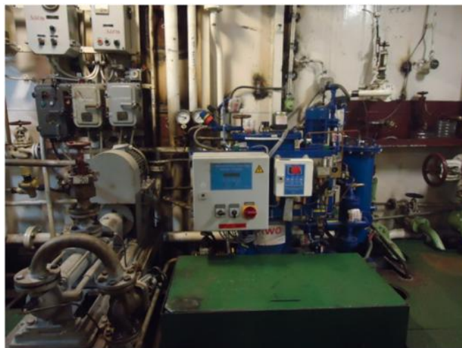
Рисунок 2.10. Пример установки оборудования RWO OWS -COM в машинном отделении буксировочного судна [26].
