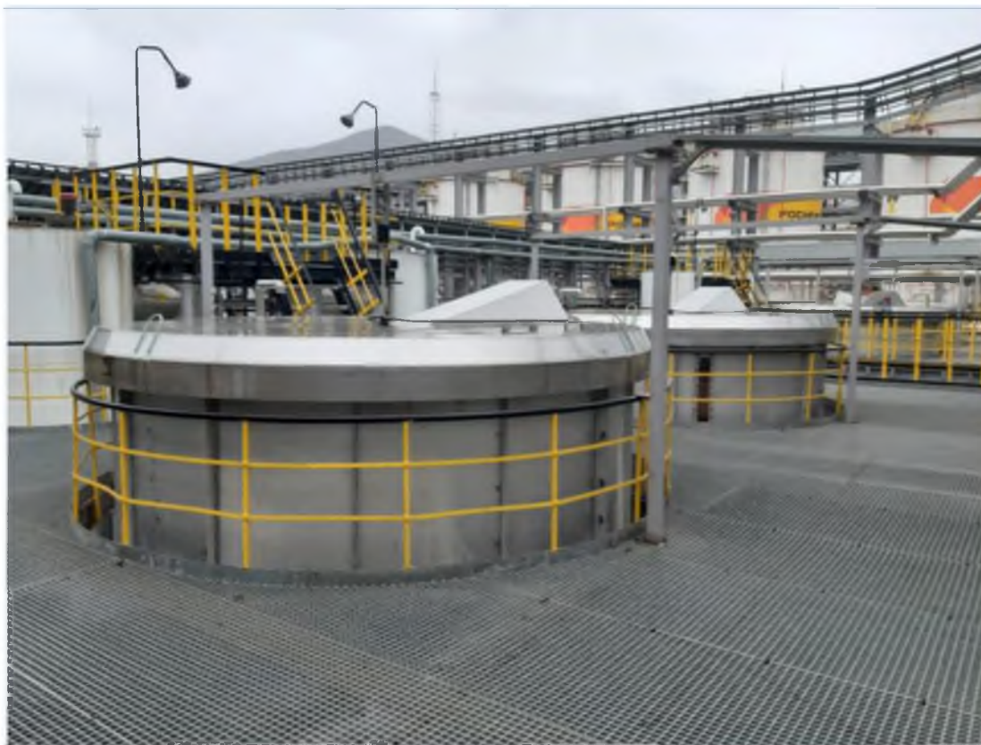
Рисунок 6 – Флотаторы очистных сооружений
