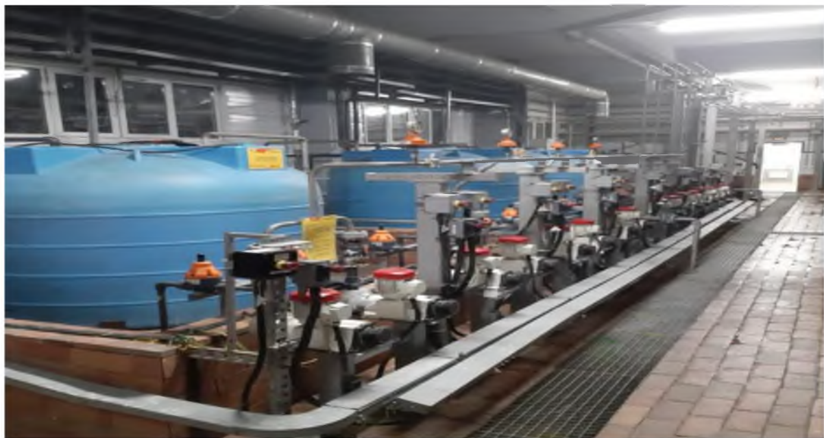
Рисунок 10 – Станция приготовления и дозирования раствора коагулянта
