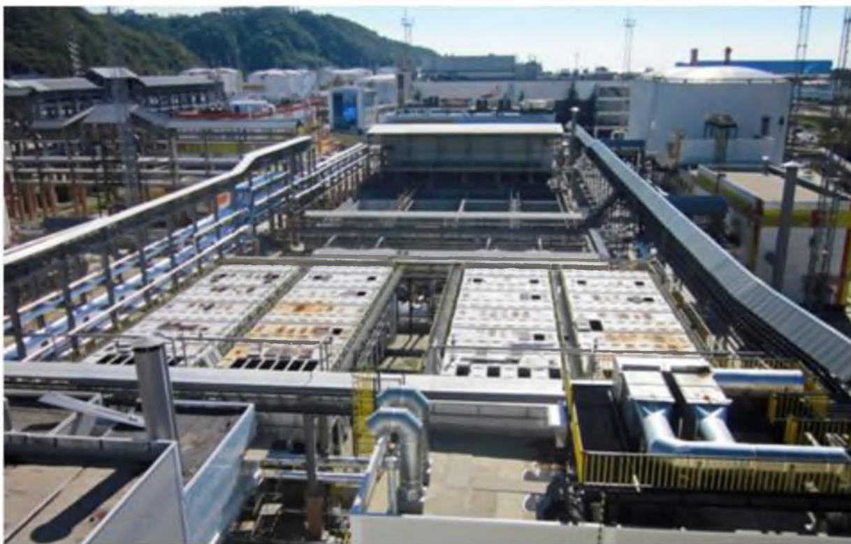
Рисунок 4 – Очистные сооружения на ООО «РН-Туапсинском НПЗ»
