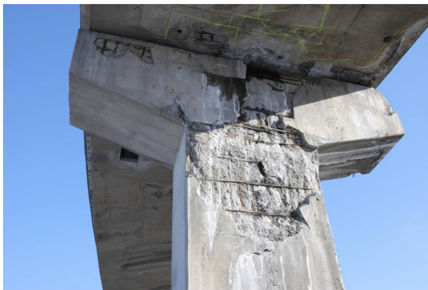
Рисунок 1.11 – Трещины в бетонной конструкции
