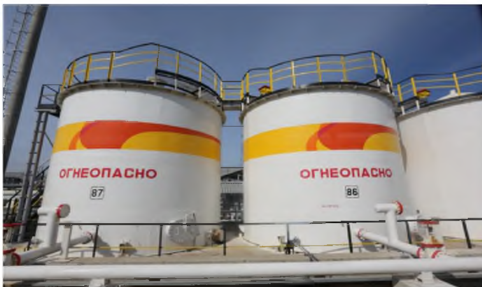
Рисунок 2.3 — Резервуары с нефтепродуктами
