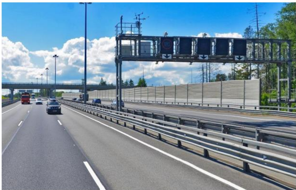
Рисунок 2.6 - Автоматическая дорожная станция «116-й километр КАД»
