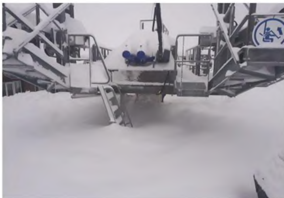
Рисунок 3.14 – Вид опоры №1 КД №5, засыпанной лавиной №128 14.03.2019 г.
