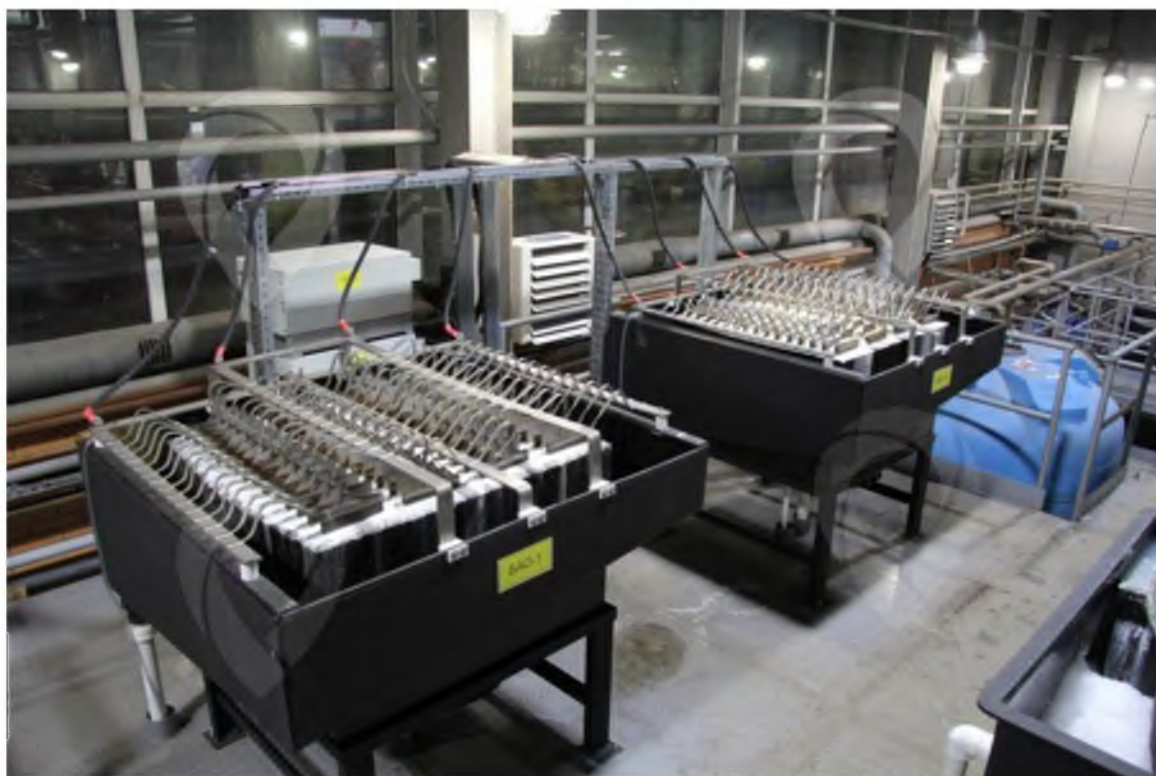
Рисунок 3.3 – Установка анодного окисления
