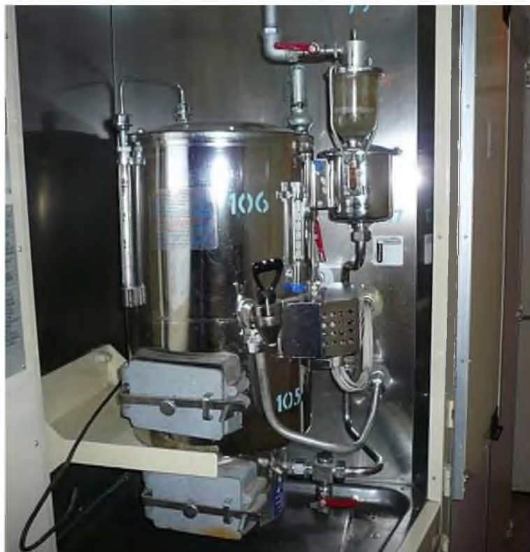
Рисунок 1.4 — Бак подачи воды
