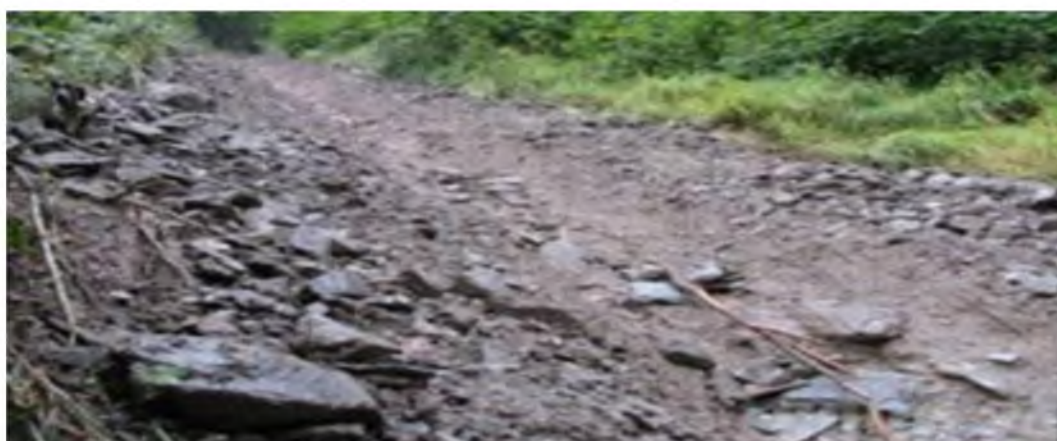
Рисунок 3.9 – Оползень в микрорайоне Блиново Адлерского района [7]
