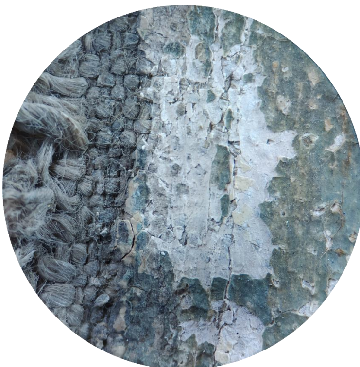
Ил.2. Участок механического повреждения на левой кромке
