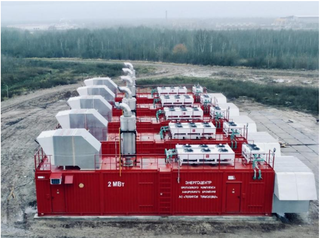
Рисунок 16 – Газопоршневые электростанции на полигоне ТКО
