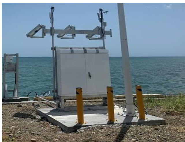
Рисунок 2.7 – Аппаратурный шкаф станции Маягуэс
