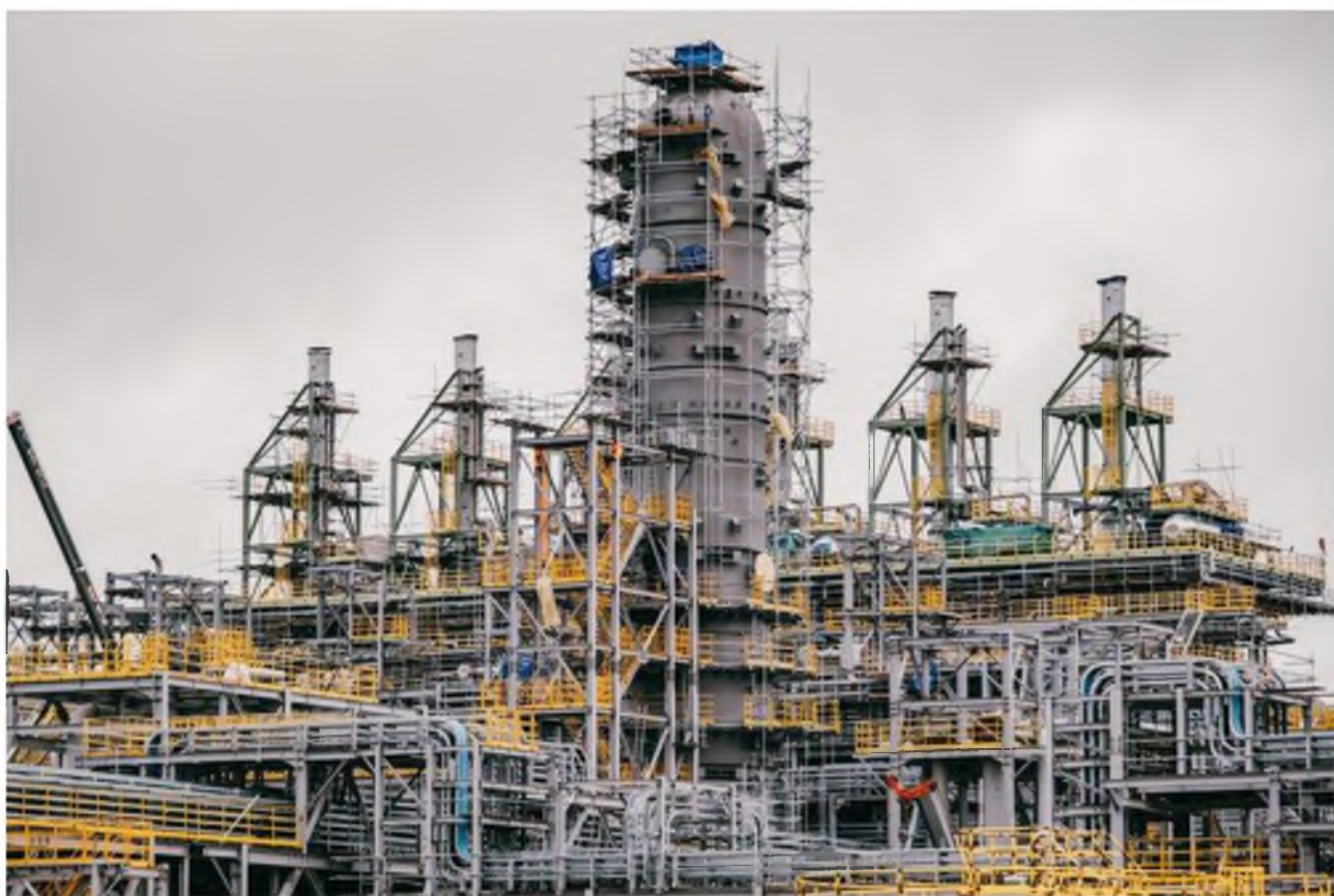
Рисунок 13 – Линия производства на ООО «Иркутский завод полимеров»
