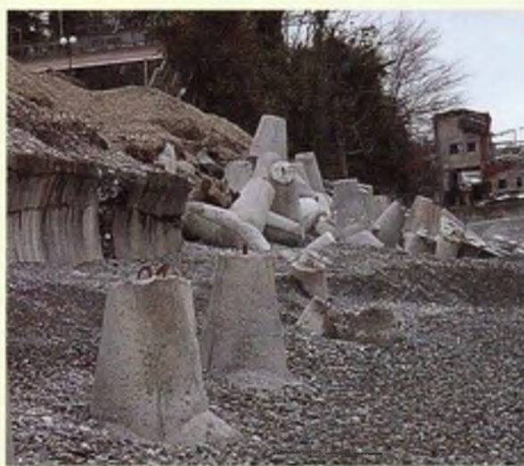
Рисунок 3.2 – Обрушение волноотбойной стены
