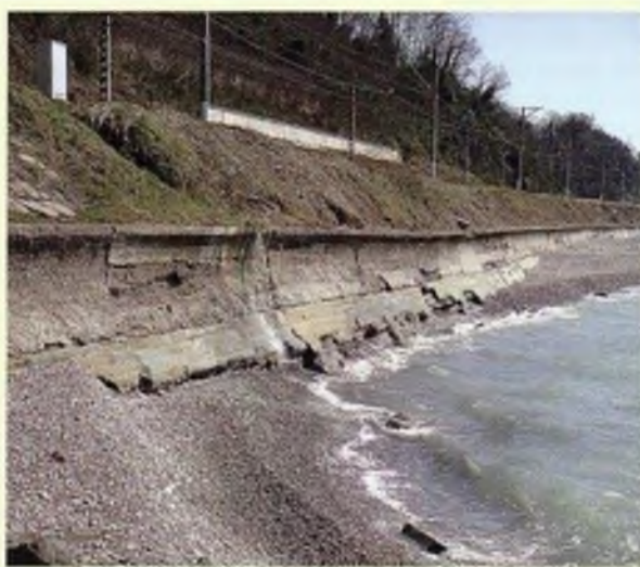
Рисунок 3.1 Выбоины волноотбойной стены
