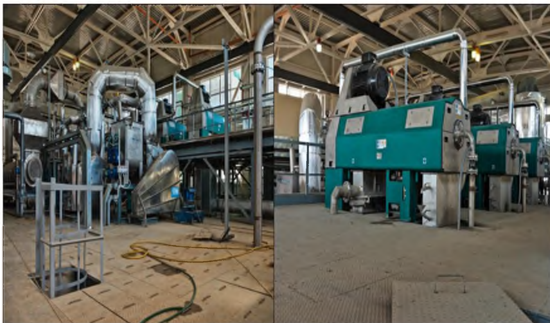
Рисунок 2.9 – Цех механического обезвоживания
